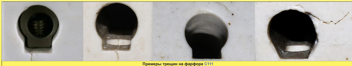
Примеры трещин на фарфоре C111
